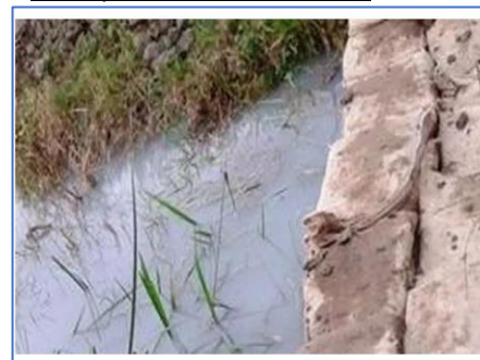
Foto 14: Fontanazzo in un fossato di scolo a 200 metri dall'argine maestro del Po
