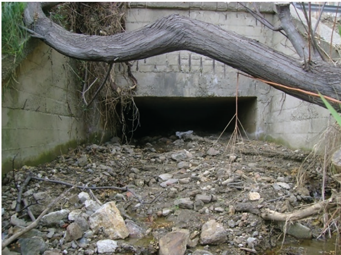
> Figura 4.3.2 Stretteie che possono generare rigurgiti (Fonte: CAMILab).
